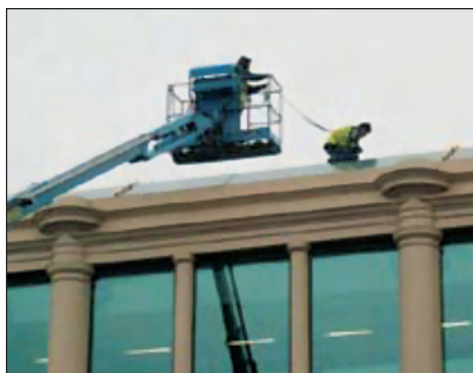
Figura 9 - Lavoro su una copertura con DPI anticaduta del lavoratore agganciato al cestello (situazione che in caso di caduta dell'operatore potrebbe determinare l'instabilità del mezzo)
